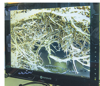
Blick in den Kanal: In der Elbeallee versperrt eine Wurzel den Fluss des Abwassers.
