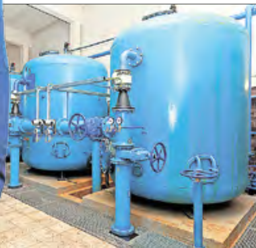
Die Kesselfilter von 1960 haben ausgedient.
