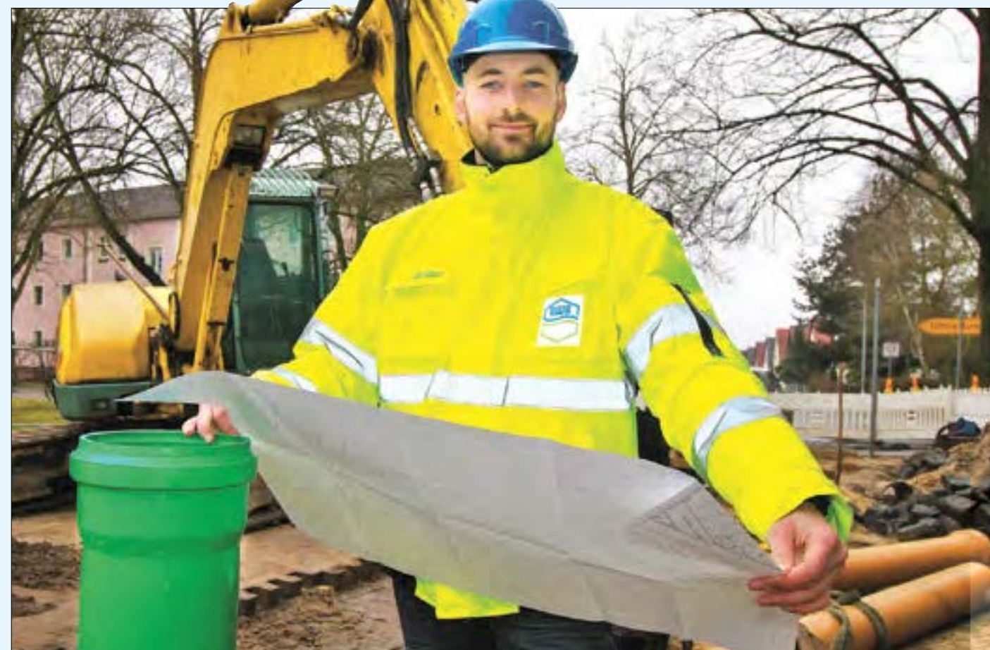
Früher verlegte er selbst Rohre, heute plant und überwacht Stephan Chmielecki die Baumaßnahmen der OWA.
