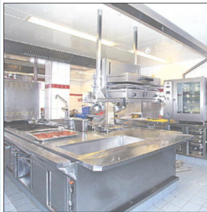
Für Großküchen ist der Einbau von Fettabscheidern Gesetz.
