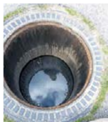
Ja, wo ist er denn? Wasser steht im Schacht.
