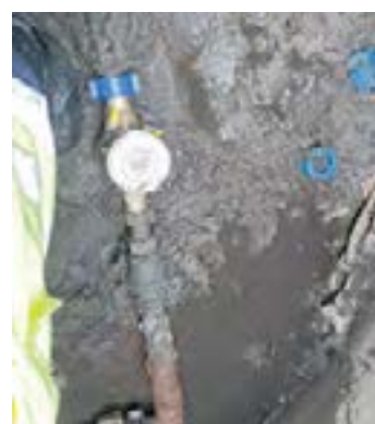
In diesem Schacht liegt der Zähler im Schlamm vergraben.
