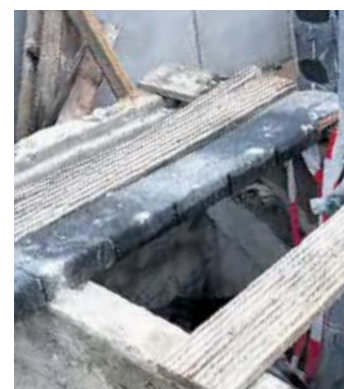
Auch das kommt vor: Der Schacht wurde zugemauert.
