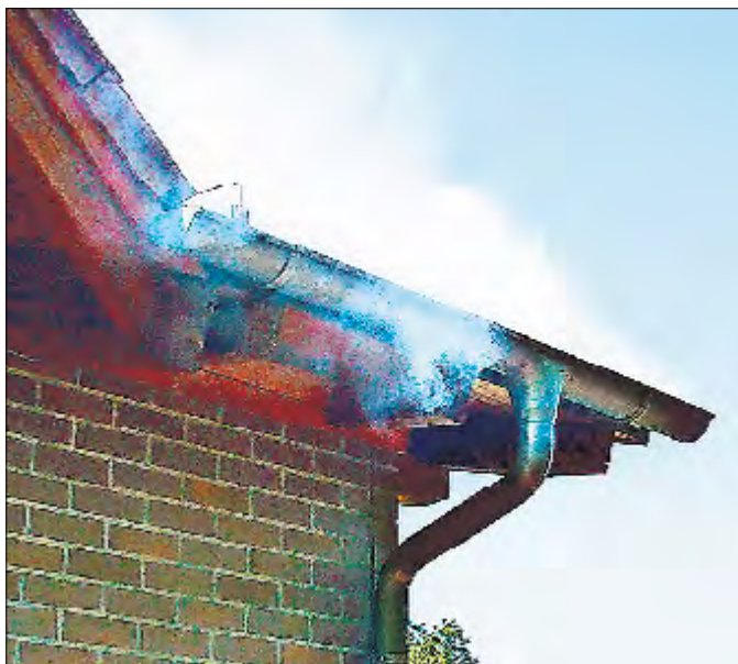
Wenn der Nebel aus der Dachrinne steigt, dann wird das Regenwasser in den öffentlichen Kanal abgeleitet.
