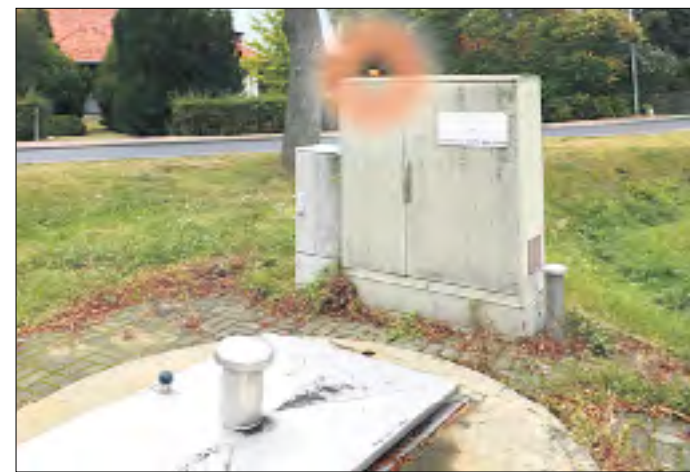
Blinkt die rote Warnleuchte an einer Pumpstation, ist es wichtig, die OWA zu informieren.
