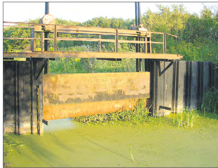
Ein nicht funktionstüchtiges Wehr am Niederneuendorfer Kanal.
