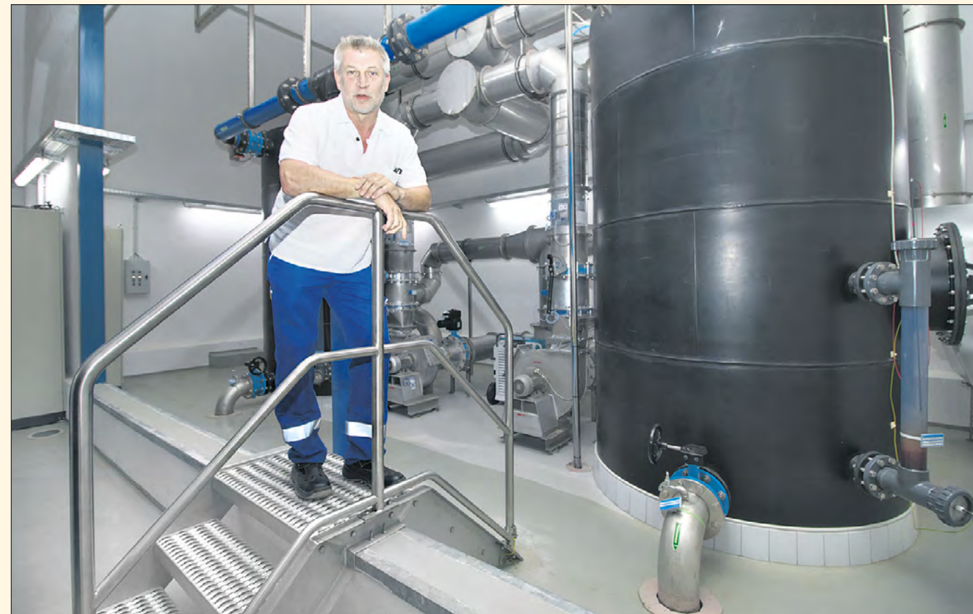
Kaum einer kennt das Hennigsdorfer Wasserwerk wie Frank Zirzlaff – hier an der Belüftung für die offene Filteranlage. Fotos (2): SPREE-PR/Petsch
